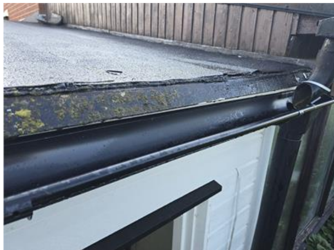
Exempel på ytpapp som släppt vid fotplåt.
