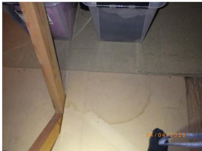
Missfärgning golv nockvind.
